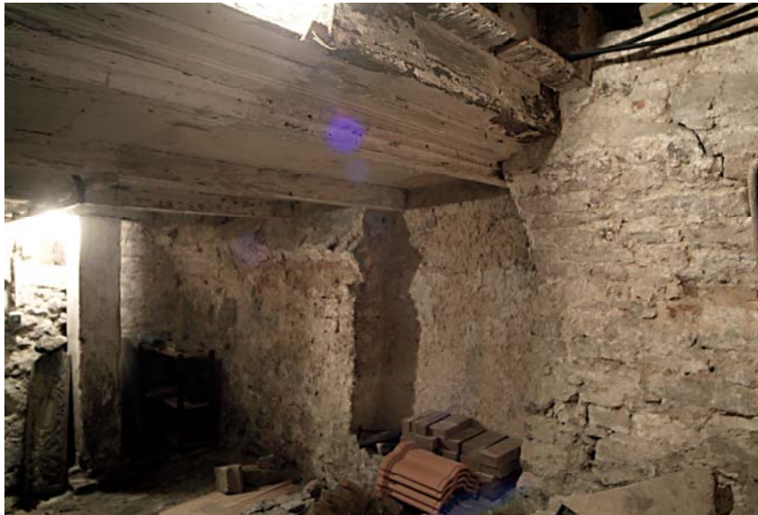
Reste des eingestürzten Gewölbes
