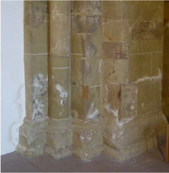
Ausblühungen von Leichensalzen, Münsterkirche Herford 13.Jh.
